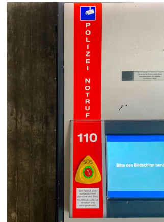
Notrufsäule bzw. -element, integriert in einen Fahrkartenautomaten
